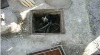
Fig.3: Pozzetto della pubblica illuminazione aperto con il transito all'interno dei 2 minitubi di TI.
