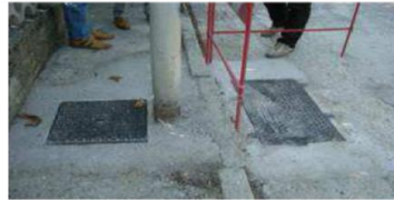
Fig. 1: I pozzetti che ospitano le infrastrutture degli Enti e di TI debbono necessariamente essere separati. Nella Foto il pozzetto della pubblica illuminazione (a sx) e il pozzetto di TI (a dx).
